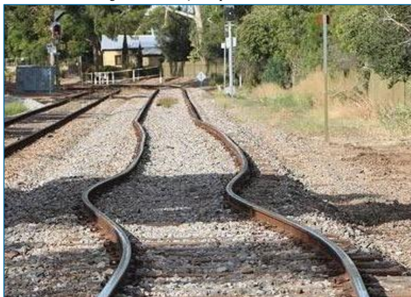
Figura 1 - Dilatação superficial nos trilhos
